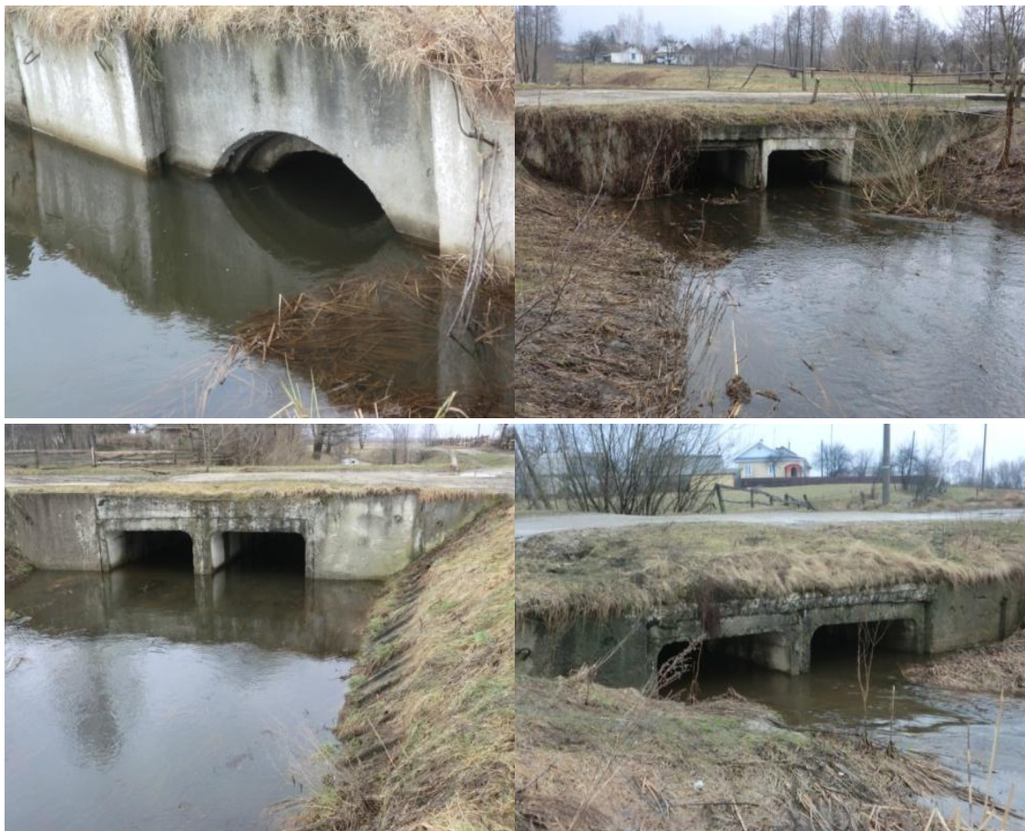
Рис. 5. Переїзди, в яких спостерігаються перекіс, лущення бетону, замулення, проростання трави та підмив споруди
